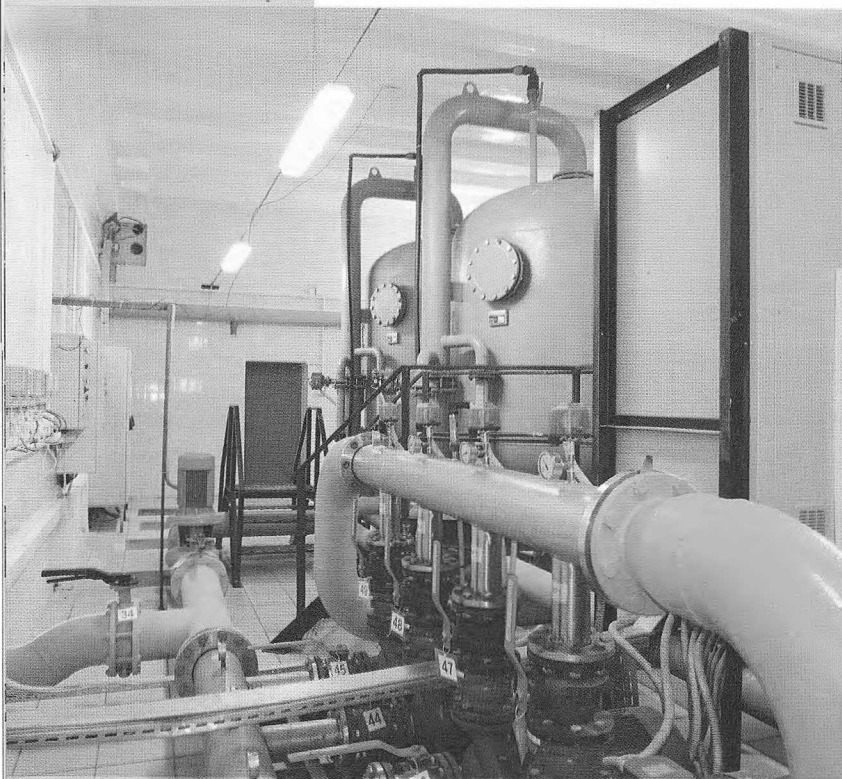
Станция обезжелезивания (г. Каменец)
